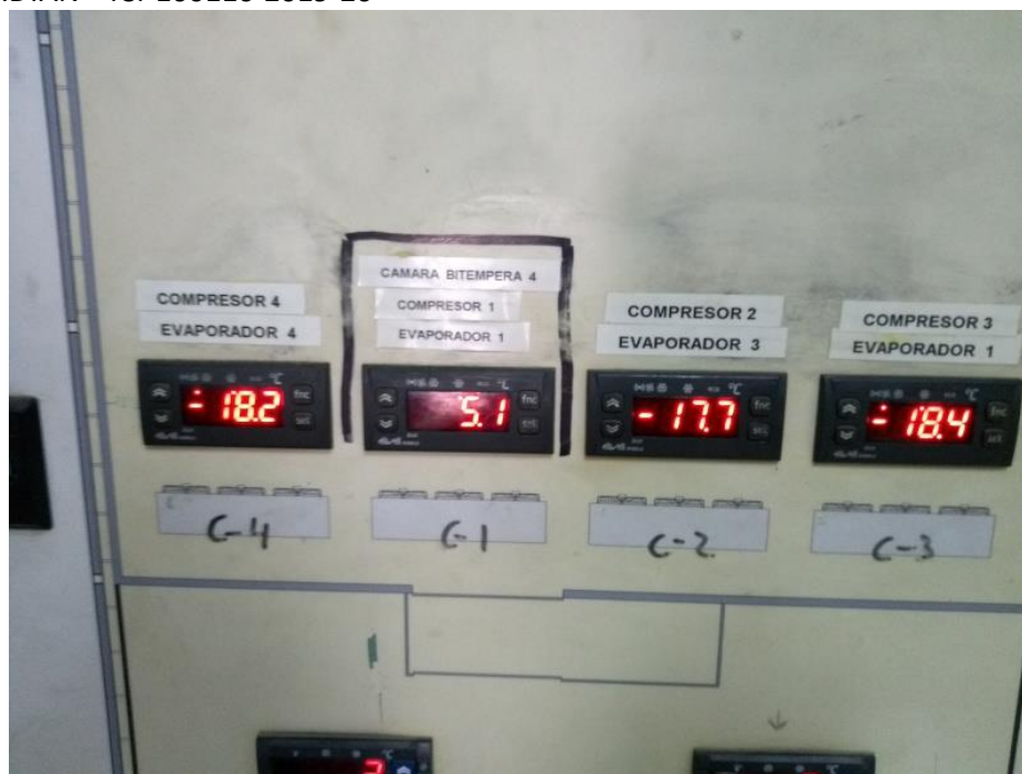
Figura 9: Indicadores de sensores de temperatura existentes
