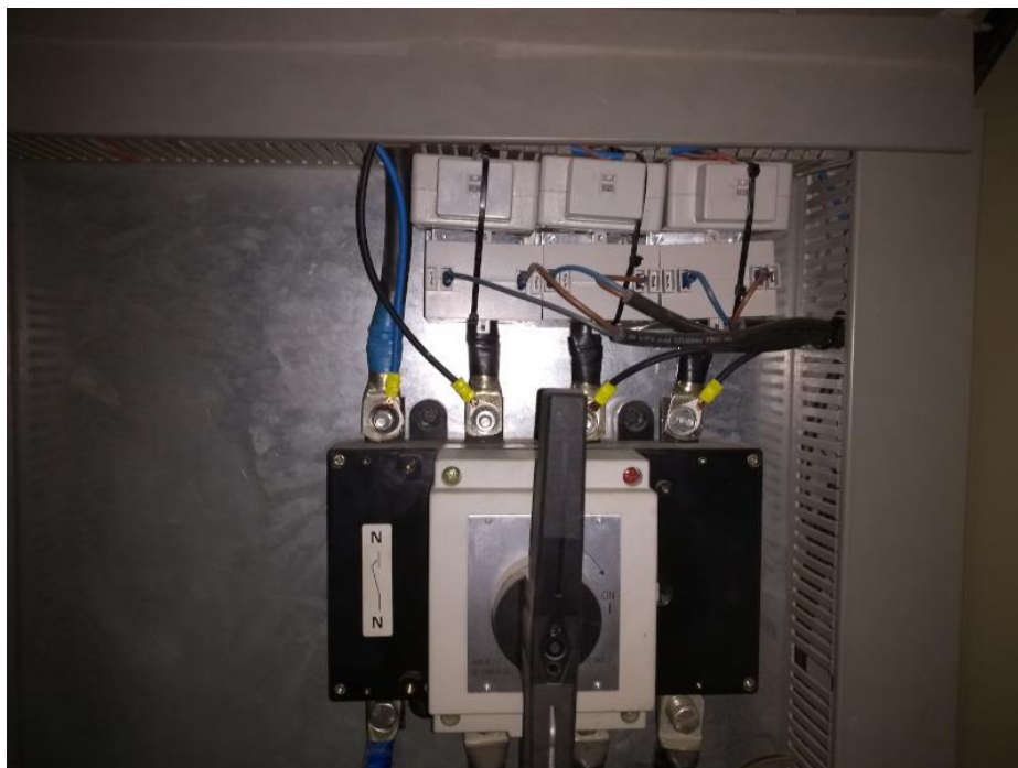
Figura 8: Transformadores para la medición de consumo de un circuito general
