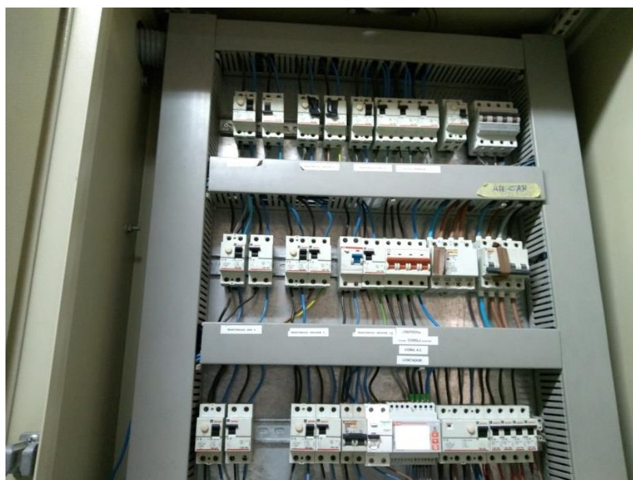
Figura 10: Cuadro eléctrico con un analizador de red para una subzona
